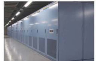
UPS（無停電電源装置）
